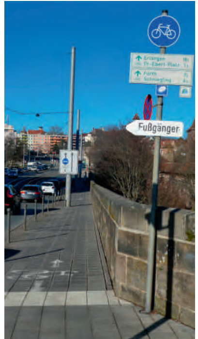
Hallertorbrücke heute: Fußweg fehlt (Foto: H. Roß)
